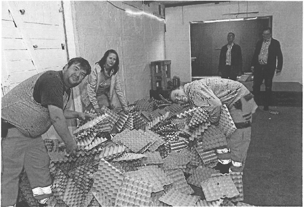
Entrümpelung: Die Bauhofmitarbeiter Sascha Brückner, Cindy Wolf und Tobias Korbach räumen die Eierkartons an die Seite, die als Schallschutz unter der Decke des Konzertraums im Güterschuppen hingen. Hinten ist noch die Bühne zu sehen, vor der sich der Technische Beigeordnete Thorsten Paulussen und Klaus Busse (von links) von der Bauverwaltung umschaun. FOTO: BOCKWINKEL
